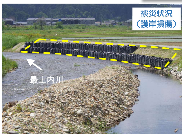
大雨で河川の水が増え、護岸が崩れました
