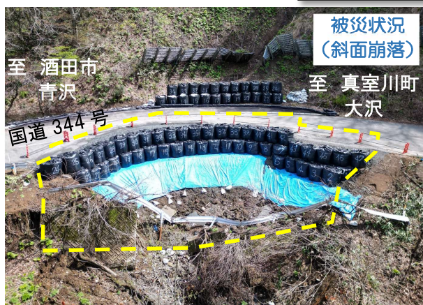
大雨で道路が崩れました
