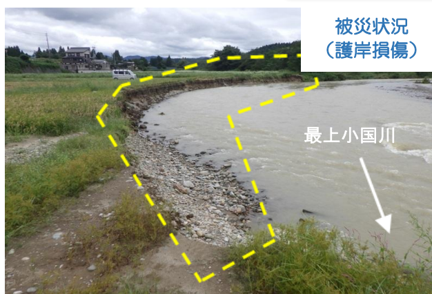
大雨で増えた河川の水で護岸が崩れました
