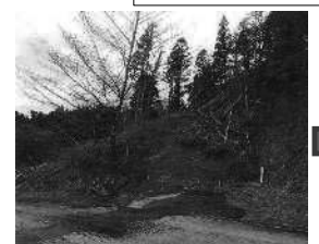
法面などの被災状況
