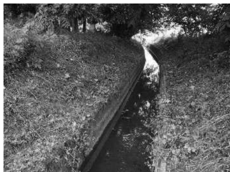
老朽化した石積み水路
