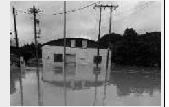
R6.7月豪雨におけるポンプ場冠水状況
