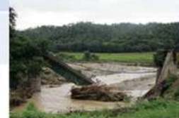
(米坂線 橋梁の流出)
