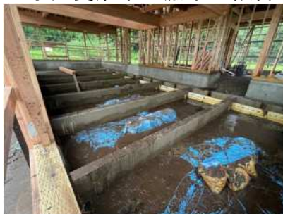
サケふ化場（遊佐町直世）の泥堆積〔令和6年7月大雨〕
