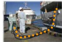
電力供給設備
