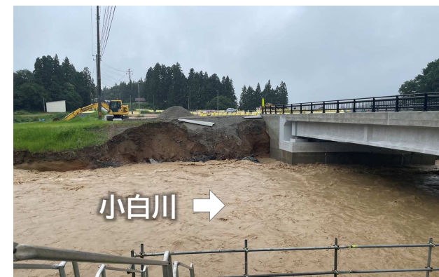
小白川 護岸流出（飯豊町）
