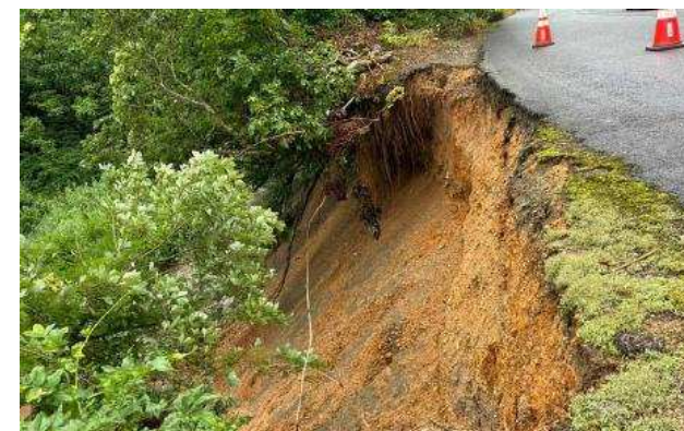
川西小国線 路肩損壊（小国町）
