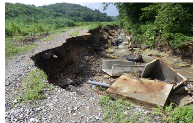
農道、水路の崩落（川西町）
